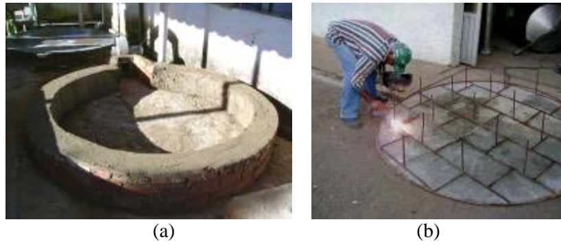
Figura 41 - Detalhes da base do silo secador-armazenador: (a) base-câmara plenum ; e (b) piso em chapa perfurada.
